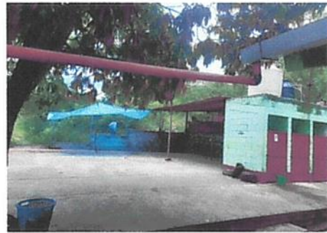
foto 2: MODULO 1 EL PATIO NO TIENE TECHADO Y ESTO ES PERJUDICIAL PARA LAS ACTIVIDADES CULTURALES, PEDAGOGICAS Y DEPORTIVAS
