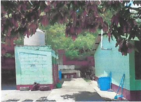
Foto1: MODULO 1 EL PATIO NO TIENE TECHADO Y ESTO ES PERJUDICIAL PARA LAS ACTIVIDADES CULTURALES, PEDAGOGICAS Y DEPORTIVAS
